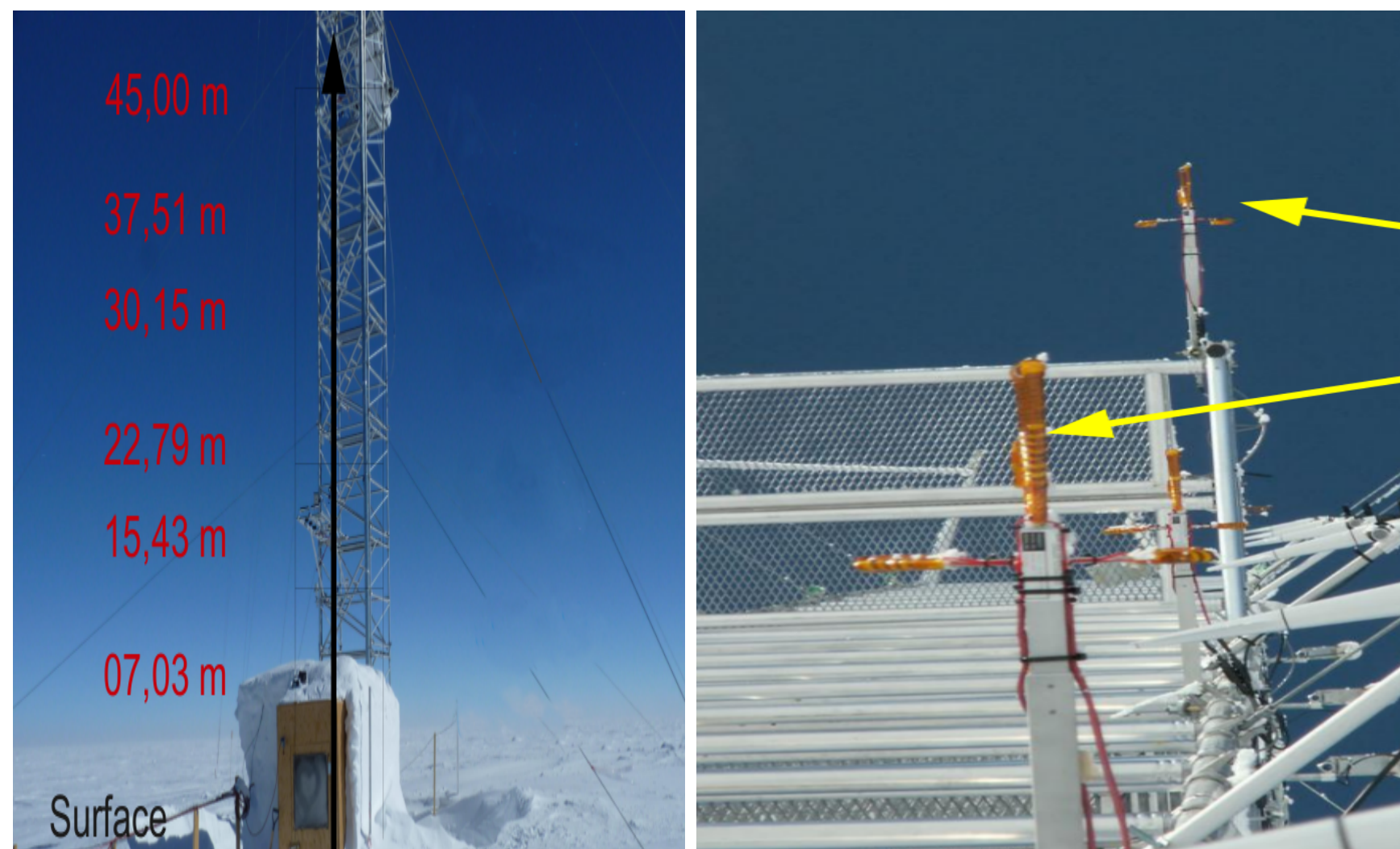
↑(gauche) Vue de la tour de 45m installée à Dôme C. (Droite) Vue de deux anémomètres soniques.
